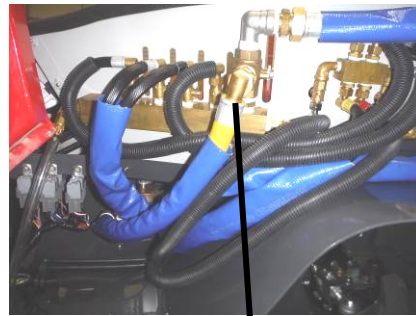
調圧弁部の配管
