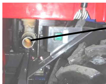
給水ポンプの ジョイント部
