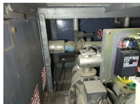
受水槽内部①
