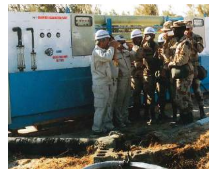
災害時緊急給水RO
